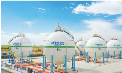
内蒙古华电氢能 20 万千瓦新能源制氢示范项目储氢罐区。 新华网发
